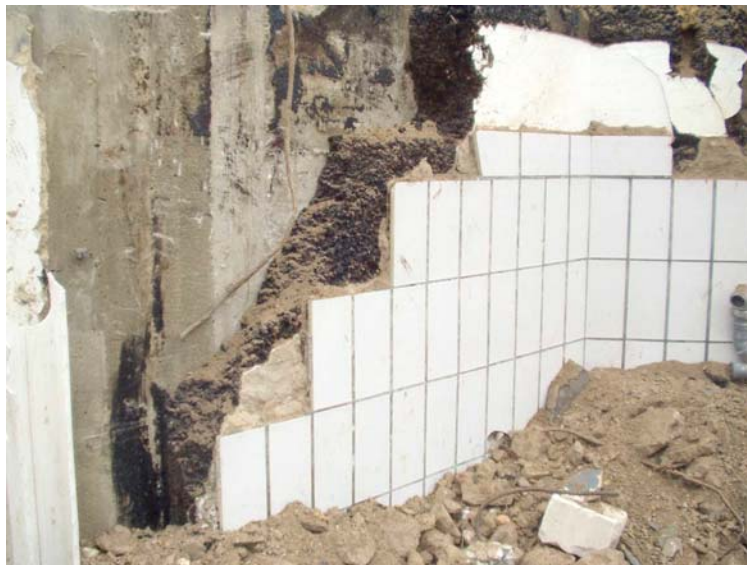
Abb. 1: PAK-belasteter Teerkork hinter Wandfliesen
