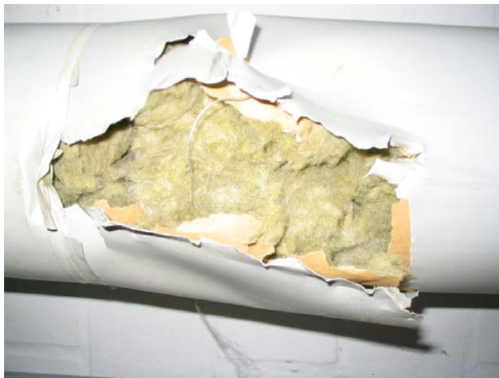
Abb. 2: Mit künstlichen Mineralfasern (KMF) ummantelte Rohrleitungen
